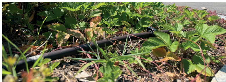
SCHLAUCHSYSTEM ZUR BEWÄSSERUNG
